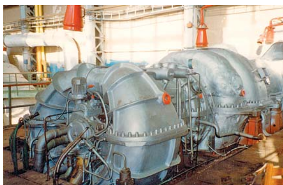
Рис. 1. Газотурбинная установка ГТК-10
