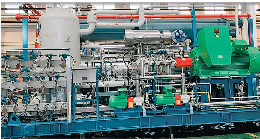
Рис. 3. Каскадная холодильная установка на базе винтового компрессора Yantaimoon
