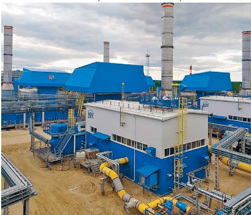
Рис. 4. ГПА ангарного исполнения. Южно-Русское месторождение, ЯНОА
