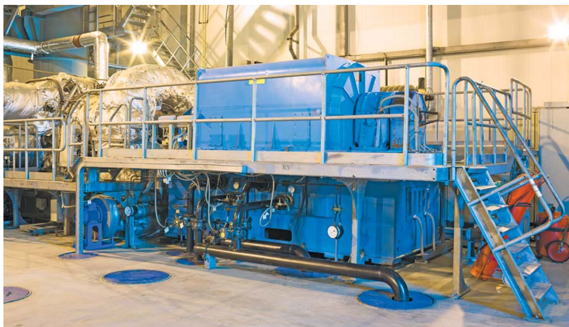
Рис. 3. Компоновочные решения АО «ГТ Энерго» обеспечивают полный доступ ко всем элементам энергоблока для выполнения регламентного обслуживания, в том числе капитального ремонта
