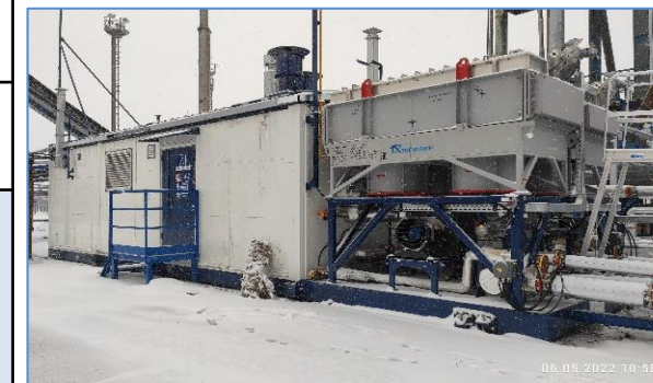
МКУ-001 на площадке ГПН-ННГ проходит ОПИ
