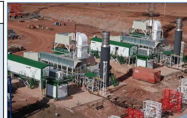
ГТЭА-6МВт в ООО «Иркутская нефтяная компания»
