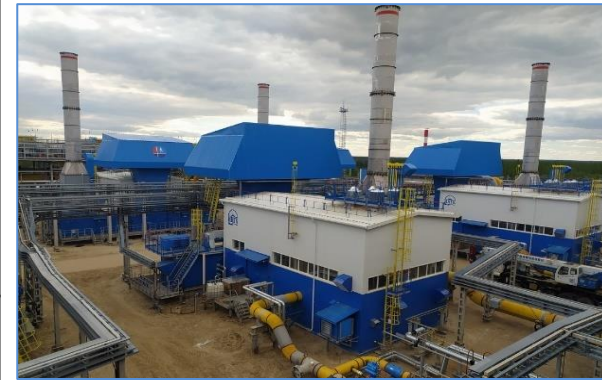
ГПА-16МВт в ООО «Севернефтегазпром»
