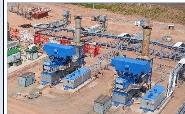
ГТЭА-6PM в ООО «Иркутская нефтяная компания»
