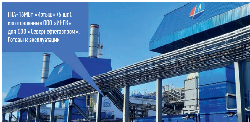
Рис. 2. Дожимная компрессорная станция Южно-Русского нефтегазоконденсатного месторождения (3-я очередь)
