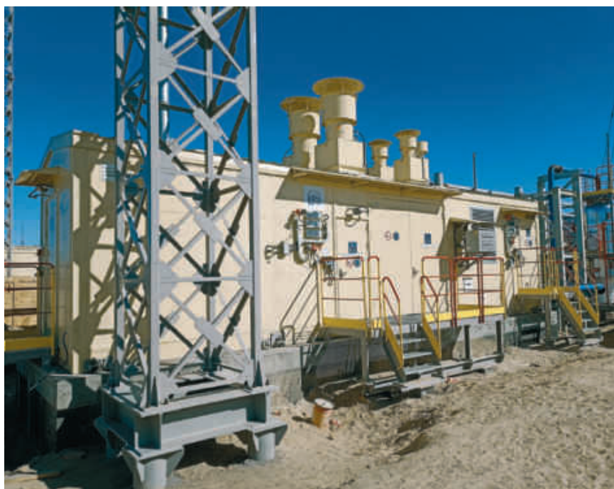
Рис. 2. ПКУ-022 блочно-модульного исполнения на Ево-Яхинском месторождении (ООО «Новатэк-Юрхаровнефтегаз» (ПАО «НОВАТЭК»))
