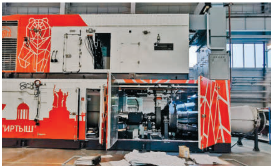
Рис. 3. Газотурбинный двигатель ГТД АА-2000 смонтирован в контейнере
