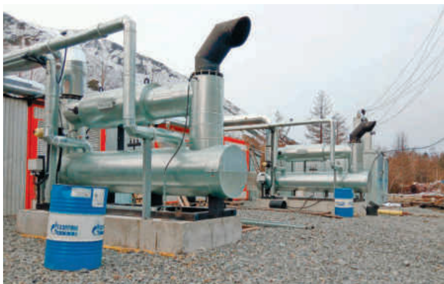
Теплообменное оборудование энергоблоков
