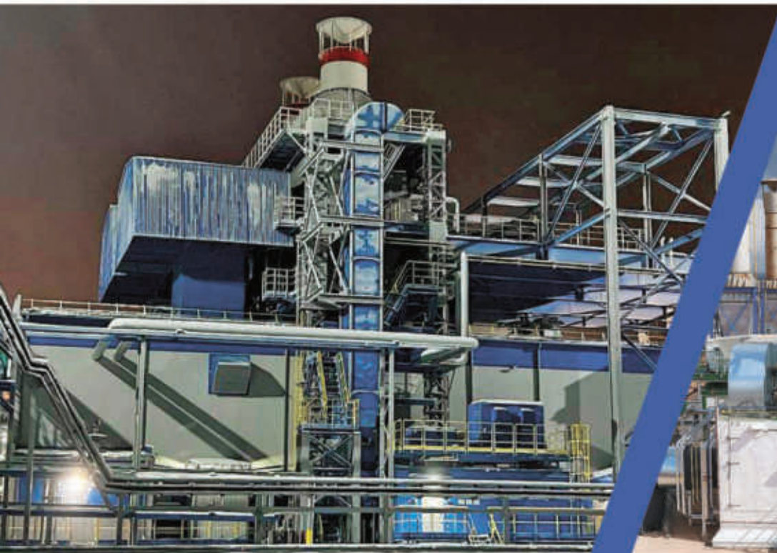
ГТЭА-12 МВт, 2 шт., ЭСН Бованенковского м/р, ООО «Газпром добыча Надым»
