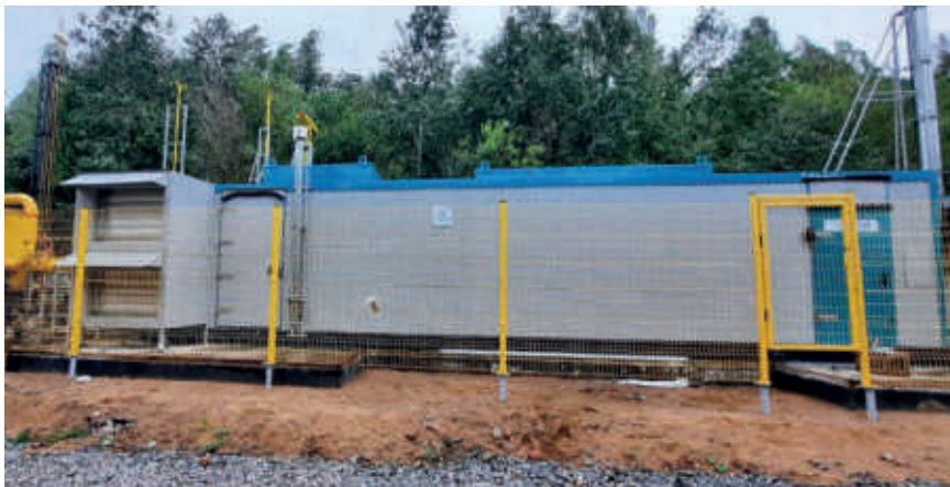
Рис. 5. Дожимная компрессорная станция COMPEX-SF-1250 и пункт учета расхода газа
