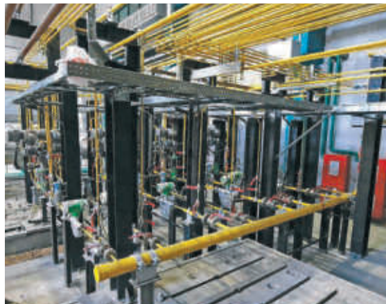
Рис. 6. Блок газообразного топлива в испытательном зале
