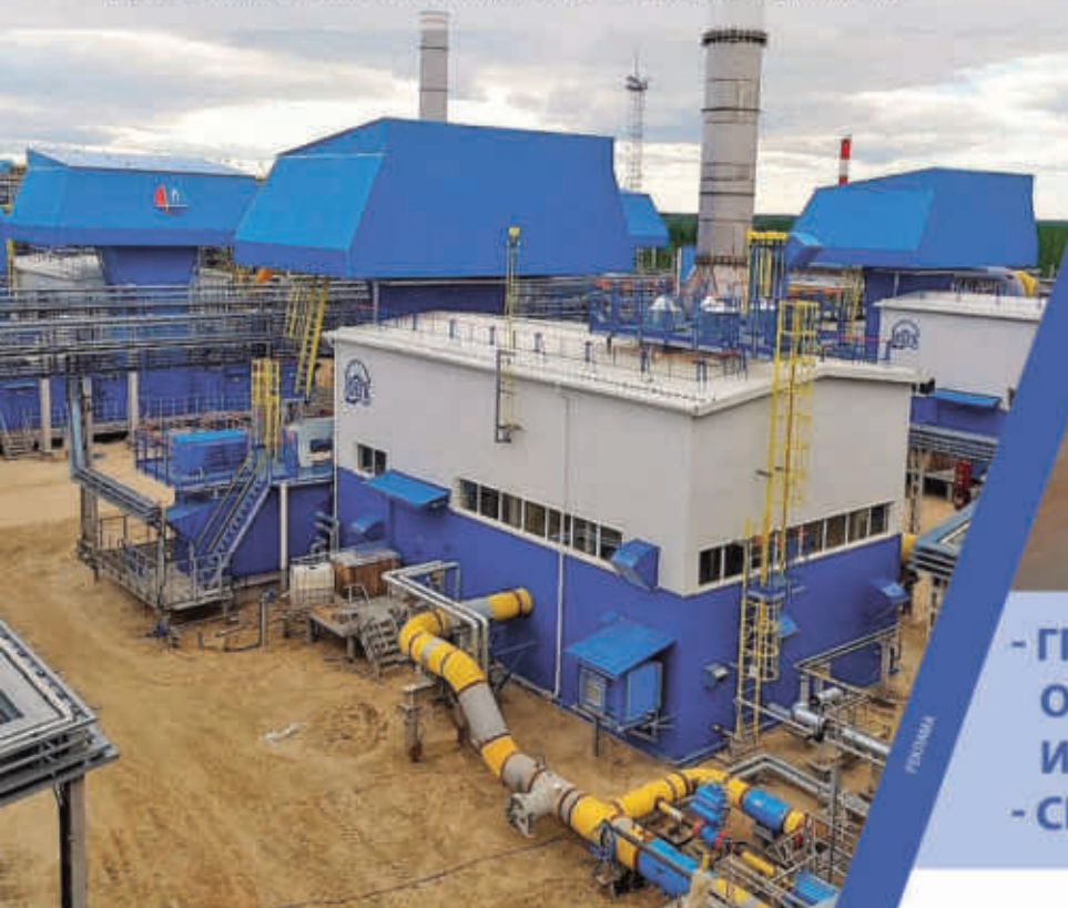
ГПА-16 МВт «Иртыш», 6 шт. ДКС Южно-Русского НГКМ, ОАО «Севнефтегазпром»
