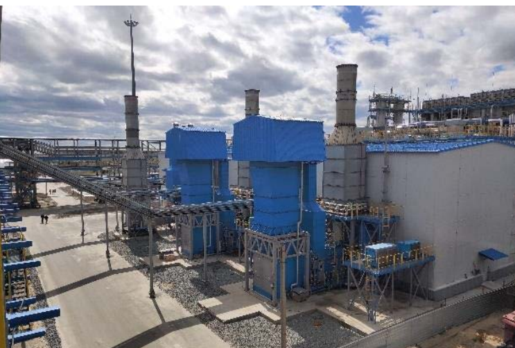
ГПА- 6 МВт в ООО «Газпром переработка»
