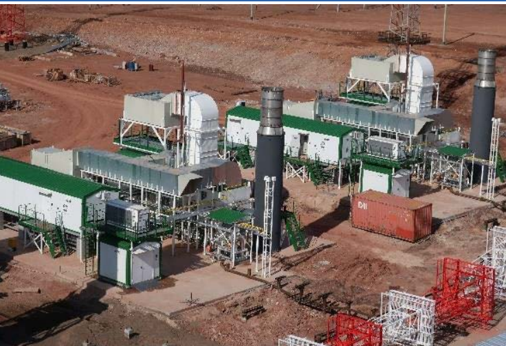
ГТЭА-6МВт в ООО «Иркутская нефтяная компания»
