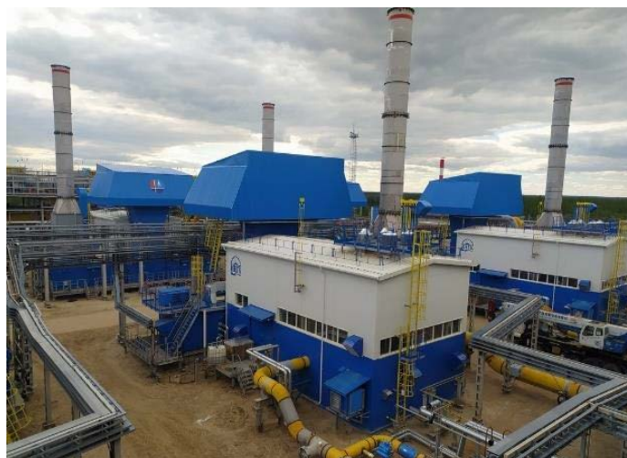
ГПА -16 МВт в ООО «Севернефтегазпром»
