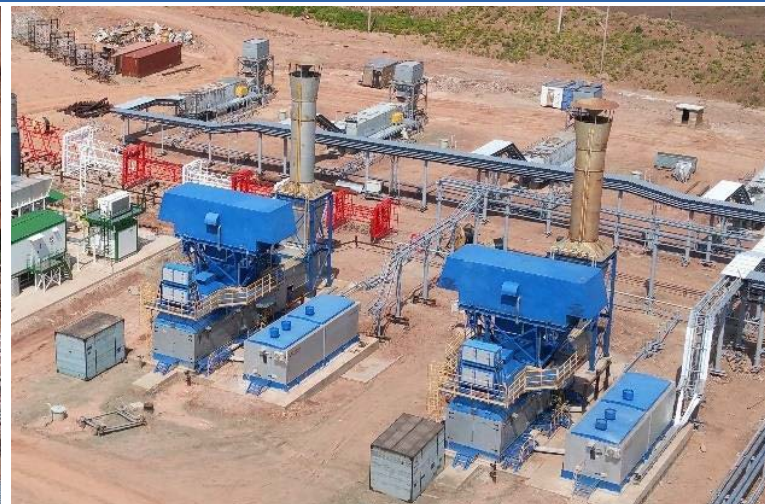
ГТЭА-6PM в ООО «Иркутская нефтяная компания»
