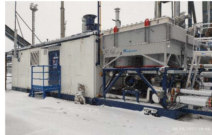
МКУ-001 на площадке ГПН-ННГ проходит ОПИ
