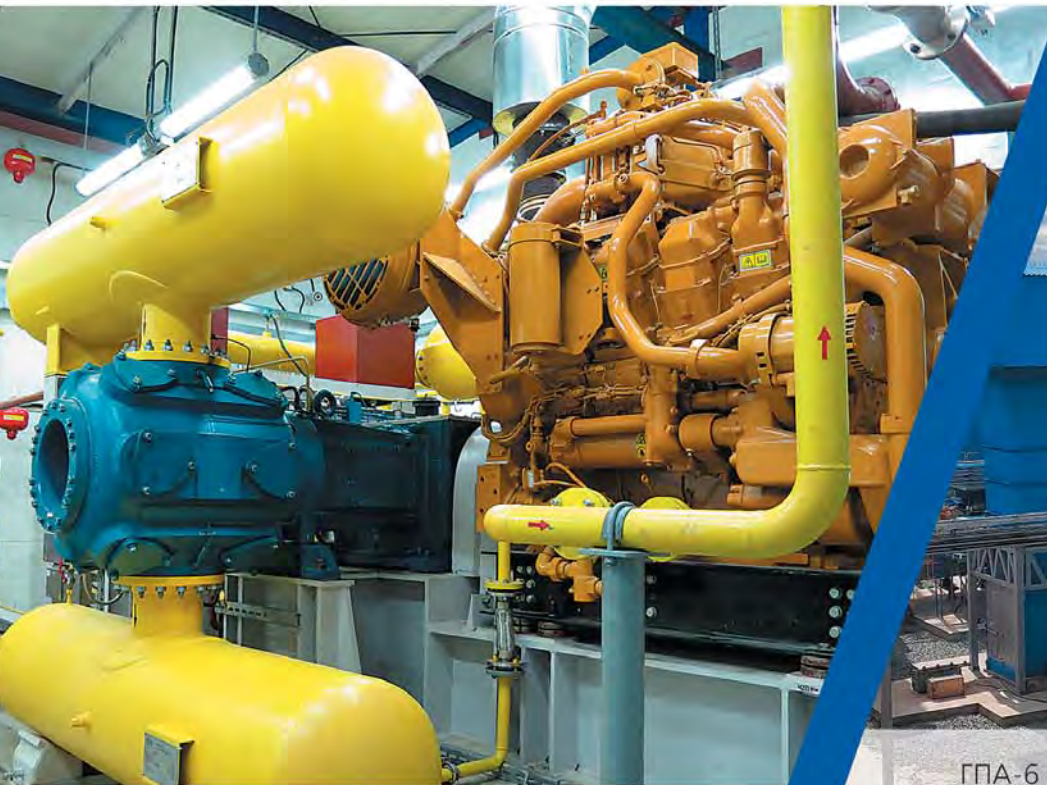
ПКУ-005, мощность 630 кВт, 1 шт. УКПГ м-я «Алибекмола», ТОО «Казах Ойл Актобе»
