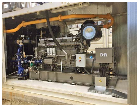
☞ Фото 8. Газопоршневой двигатель Guascor SFGM 240
