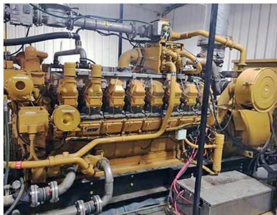
➔ Фото 1. Газопоршневой двигатель Caterpillar G3516A
