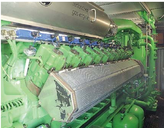
© Фото 10. Газопоршневой двигатель Jenbacher 420C
